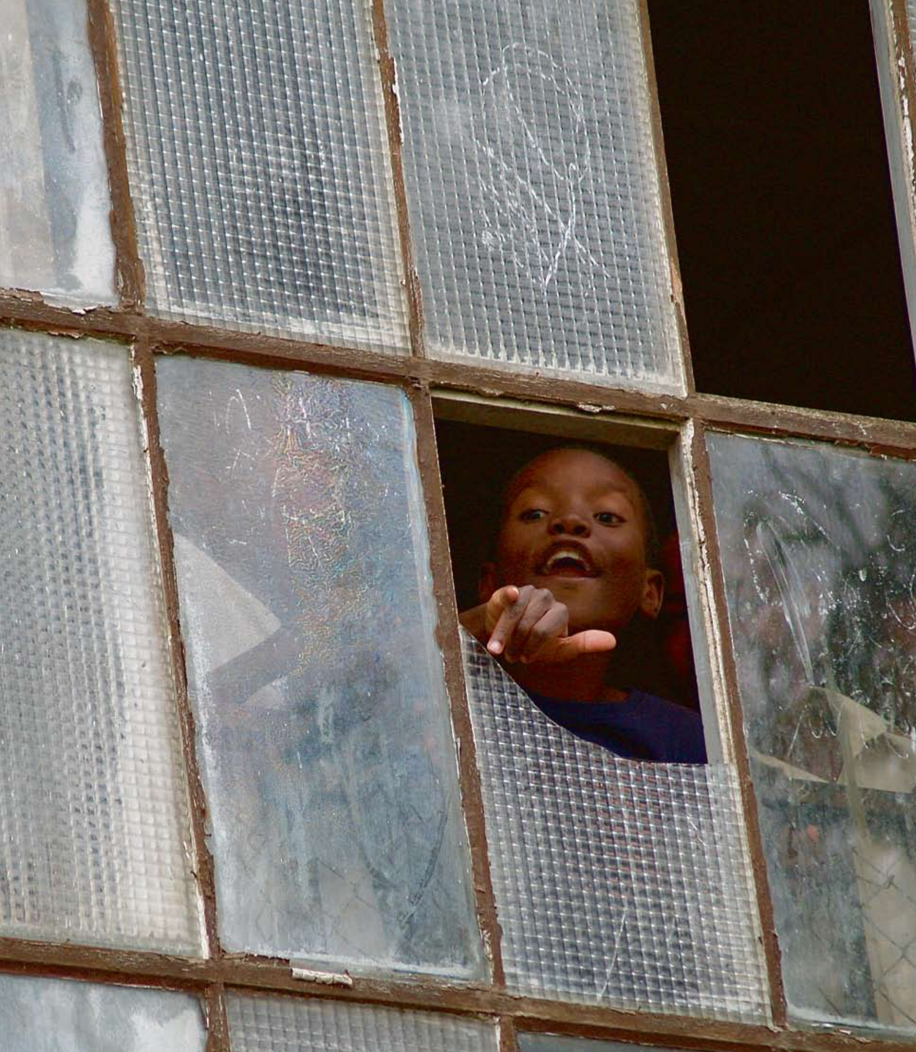
Brotnar rúður í grunnskóla í Maputo, Mósambík Broken windows at a primary school in Maputo, Mozambique
